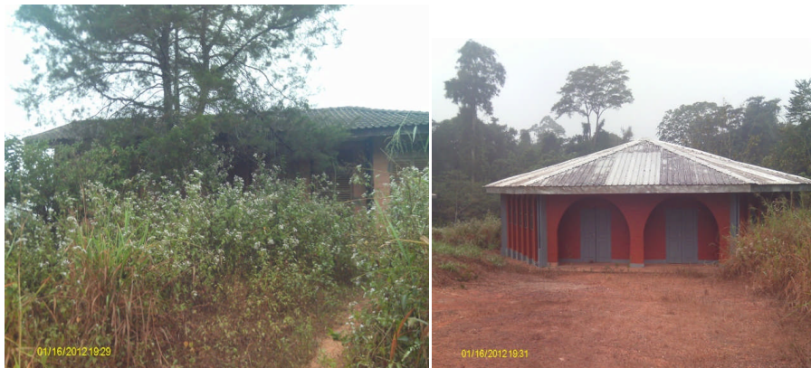
Photo 1: Bâtiments modernes abandonnés du MINFOF du site de la réserve du Dja
