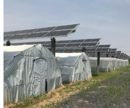
Abb. 40: PV-Module über einem Folientunnel. © BayWa r.e.
