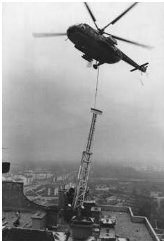
ANTENA, postavljanje antenskoga stupa odašiljača OTV-a na vrh zgrade u Ulici braće Domany u Zagrebu, 1990.
