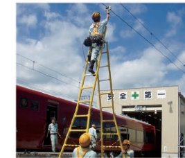
①電力設備点検の様子
