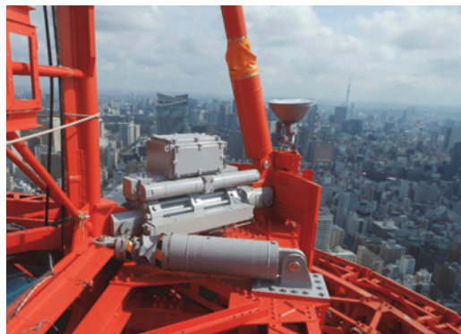
写真-5 H27制震ダンパー（更新後）
