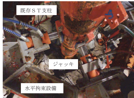
写真-8 水平拘束設備
