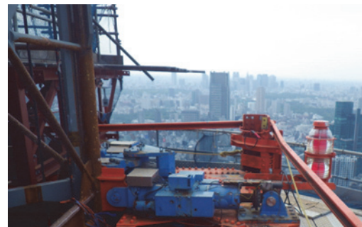
写真-4 H27制震ダンパー（更新前）
