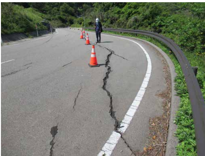
木ノ浦への分岐点（市道？）の路肩変状 次ページのシャク崎に近い箇所
