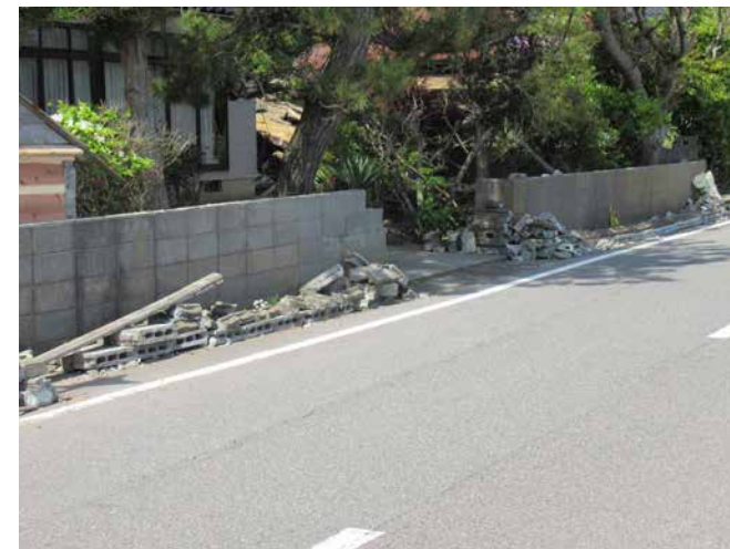
折戸町民家のブロック塀の損壊
