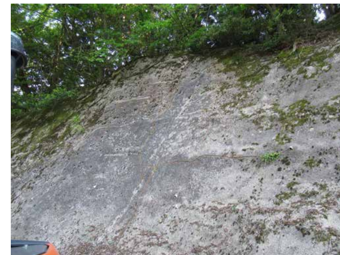
隣接のモルタル吹付面にはクラックあり
