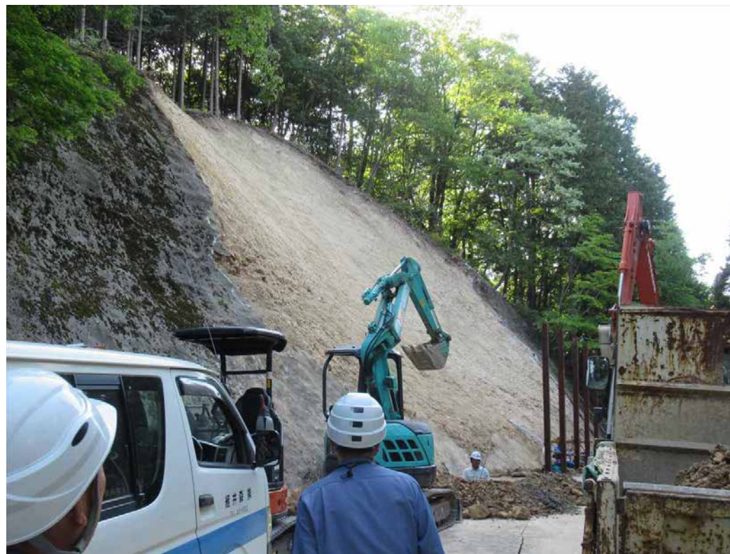
のり面崩壊箇所の復旧作業状況 崩土を除去し、仮設防護柵を設置中 地質は珪藻質シルト岩からなり、表層はモルタル吹付が施工されていた。 未崩落ののり面では、モルタル吹付にクラックがやや多く、老朽化。
