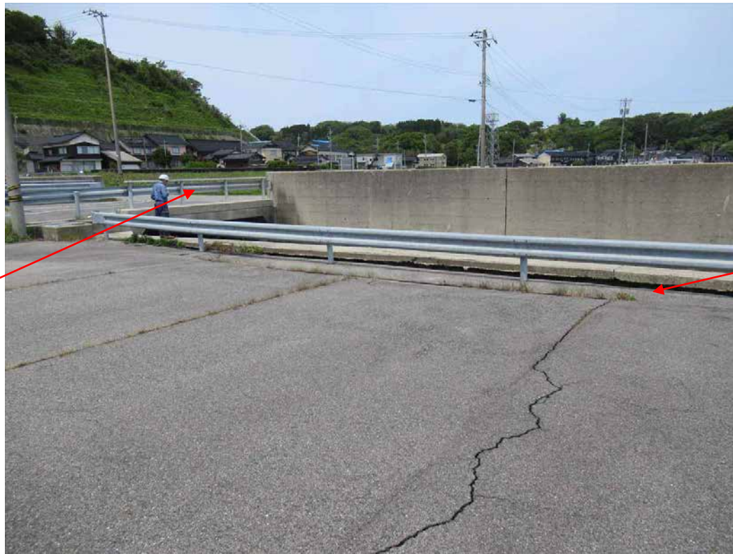
エプロン部分のクラック。写真の右側が海側
