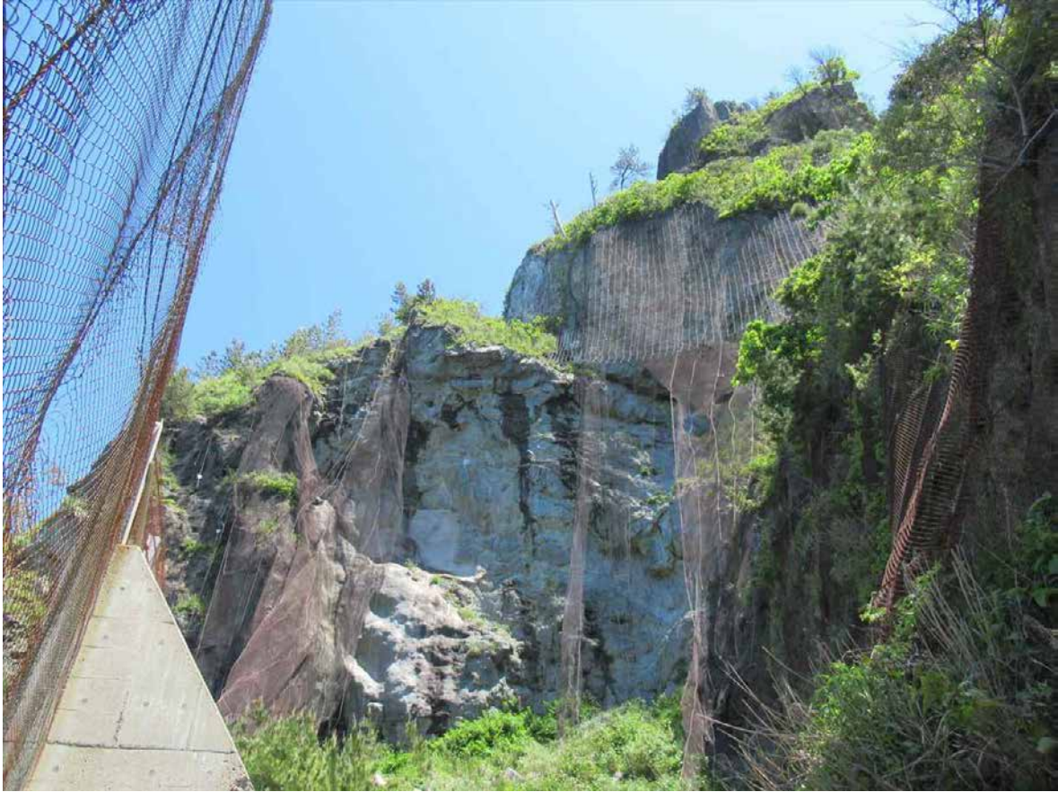
擁壁背後にも新たな落石なし
