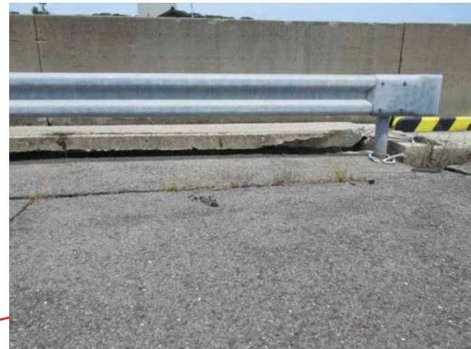
アスファルトが沈下し、擁壁天端に隙間が生じる
