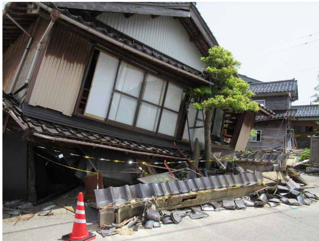
一階部分が損壊し、二階に押しつぶされている（正院町）
