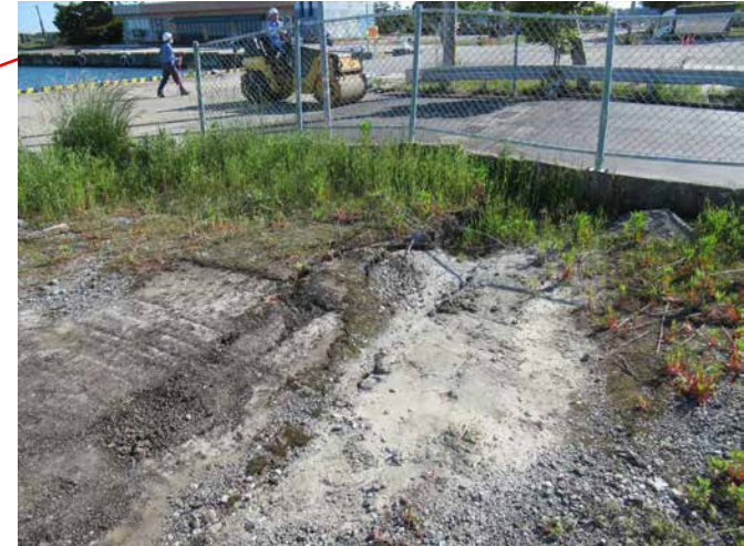
液状化による地表面の変形
