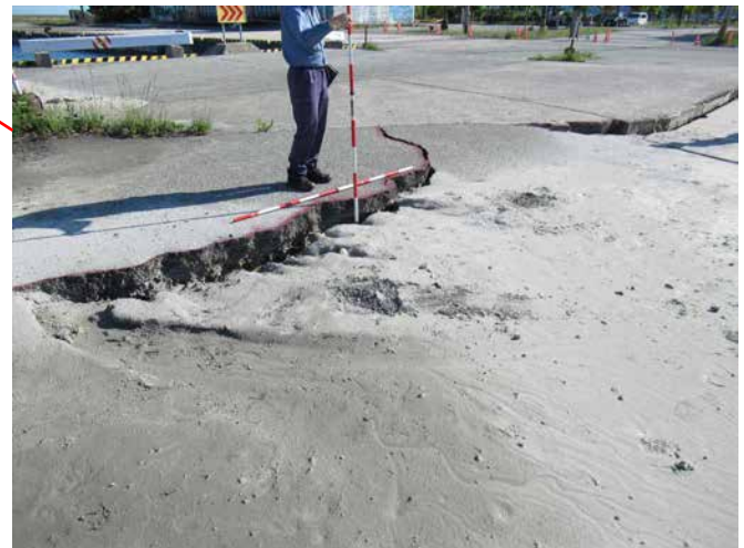
噴砂を伴う亀裂・段差
