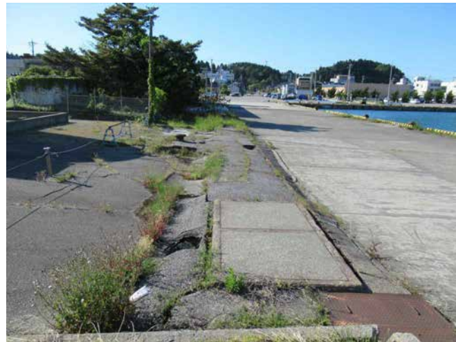
水路？の両側が沈下
