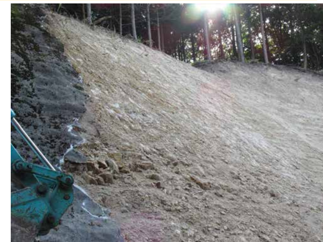
のり面状況 風化が進んでいるように見える
