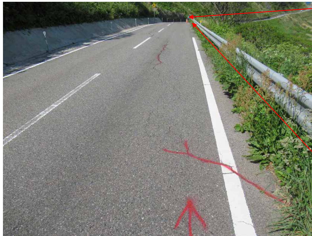
路面に生じたクラック 一部は中央線を越えている
