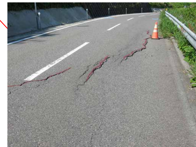
変状箇所の西側端部 段差を伴う
