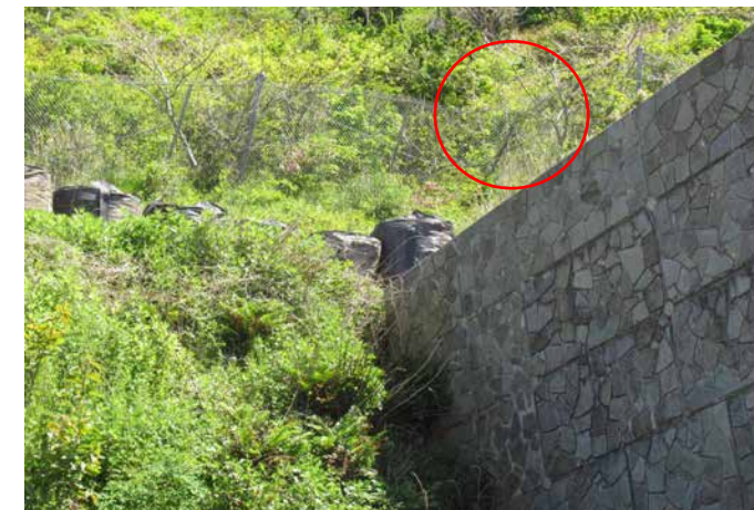
ネットが落石で変形し上を乗り越えたとみられる
