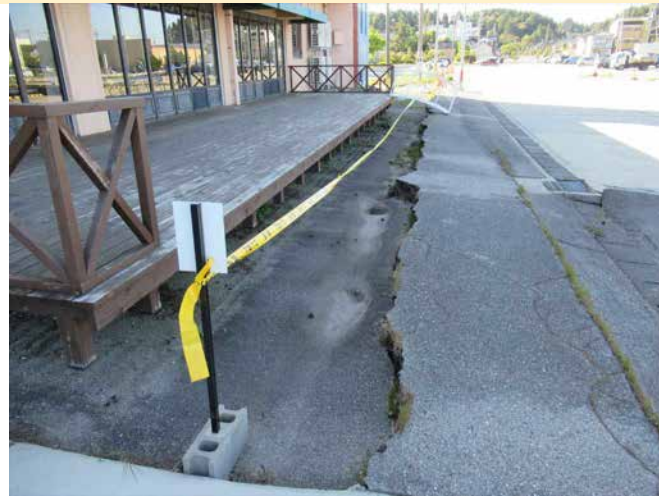
建物の横が溝状に沈下 深さ40cm程度
