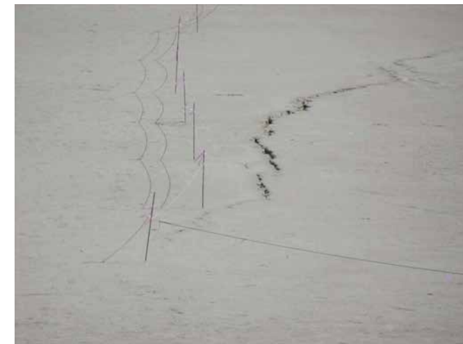
地割れの拡大写真
