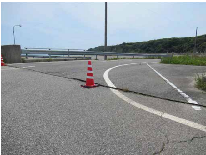
橋台部分に生じた道路の段差
