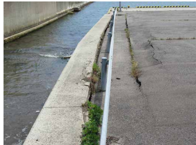
擁壁は川側に傾倒。背面が沈下
