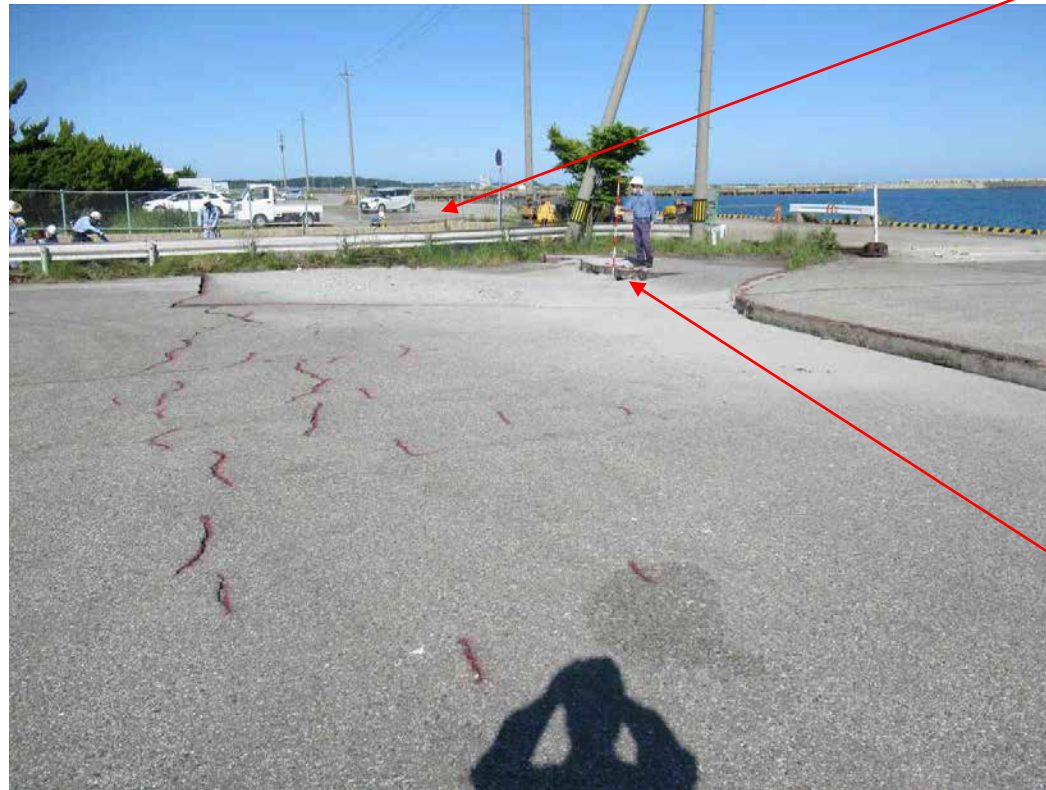
液状化により、エプロンアスファルトにクラックが多数発生。段差や噴砂もみられる。
