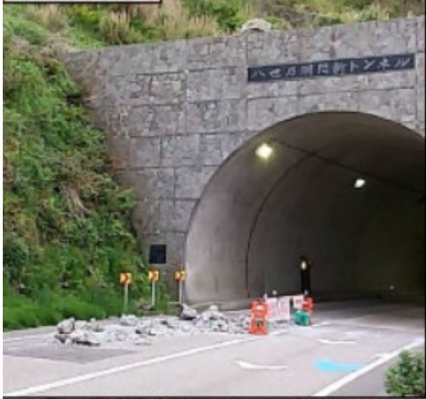
落石状況（石川県土木部 WEB公表資料）
