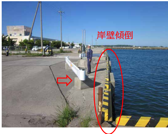
側方移動により岸壁が海側に張り出している
