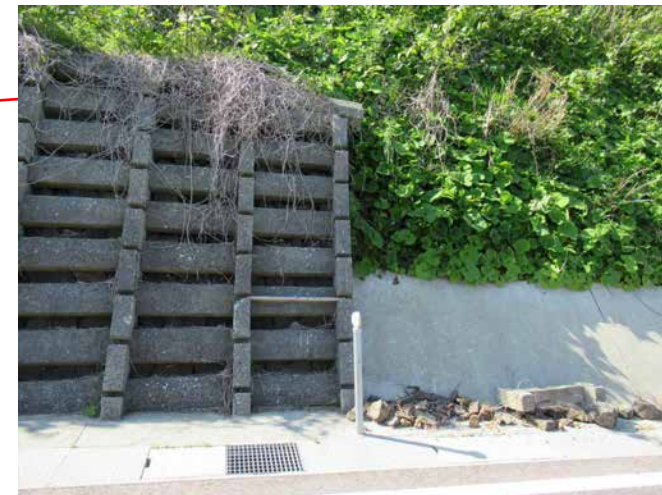
飛行機枠の上部が落下
