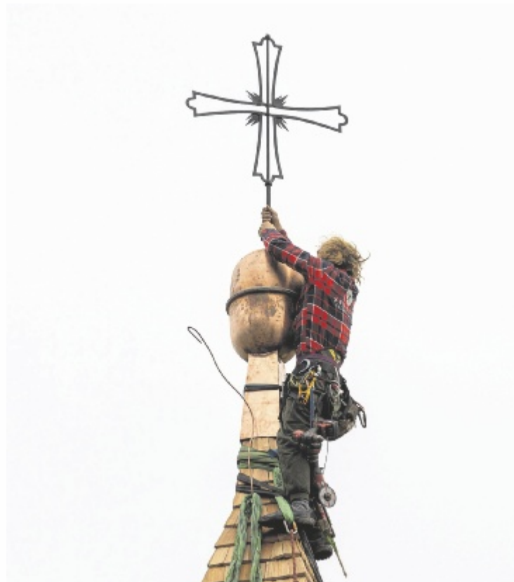
Das zuletzt 1975 gedeckte Schindeldach wurde aufgrund von Wasserschäden reparaturbedürftig. Foto: Franz Dittlbacher
